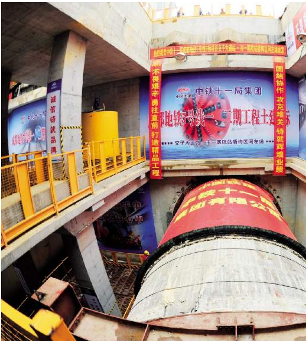
成都地铁5号线9表交子大道站至市一医院站区间左线盾构机成功始发
