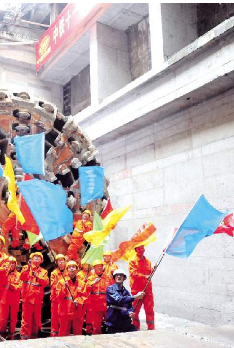
成都地铁 2 号线 5 标蜀汉东站至白果林站区间双线顺利贯通
