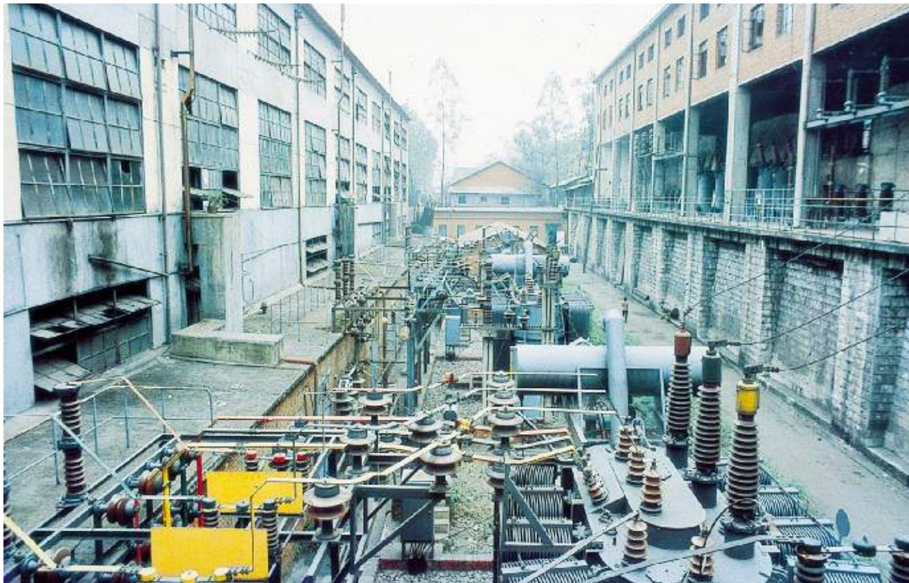
攀枝花发电厂变压器房
