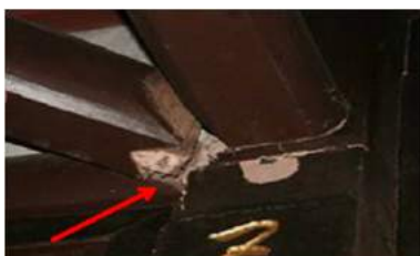
榫卯节点破损
